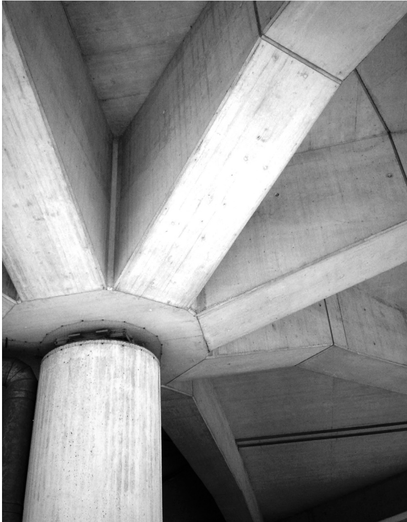
Dokumentationsfoto: Beton-Parkdeck, Achim Sauter, 2009
